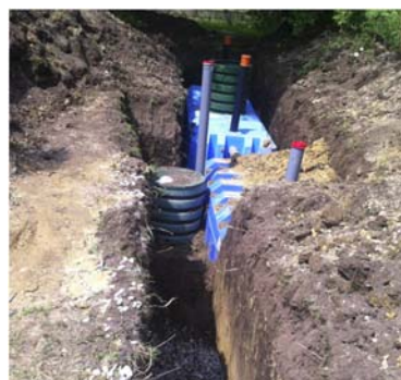
Komplett rendszer telepítése 5 főre
